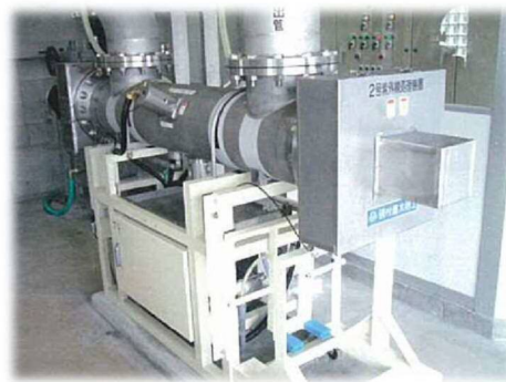
写真 5-2 クリプトスポリジウム対策施設
