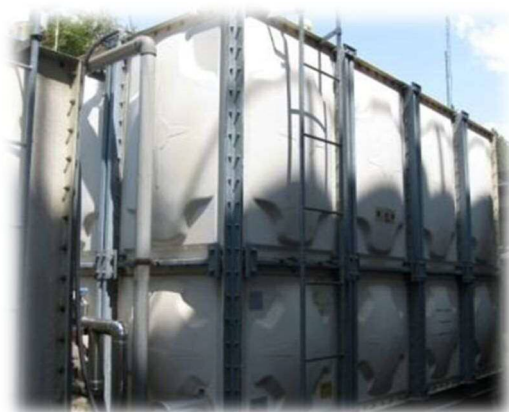
写真 5-3 貯水槽 (公益社団法人全国建築物飲料水管理協会東関東支部HPより)
