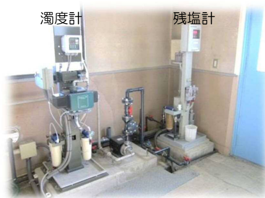
写真 5-1 水質監視装置
