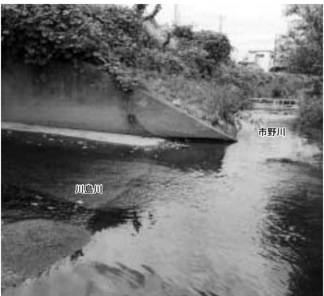
大雨のときに逆流が起こる川島川 (写真：左側)
