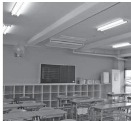
教室の空調設備
