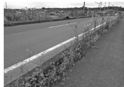
町道1-2号線歩道の雑草 = R3.10.19
