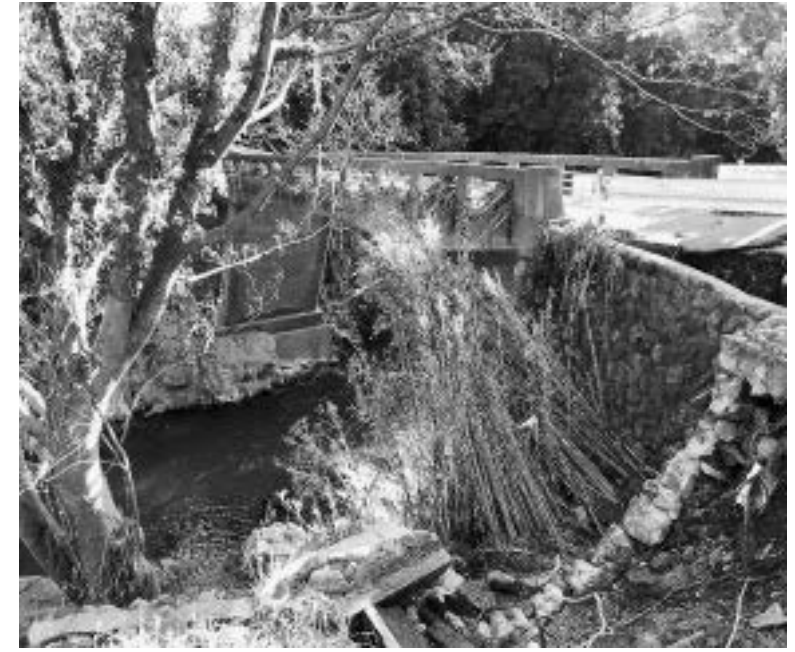
台風19号で被害を受けた遠山の谷川橋＝R元.11.5
