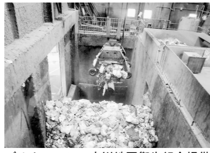
ごみクレーン=小川地区衛生組合提供
