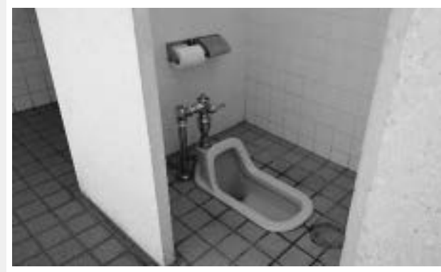
高齢者も利用する総合運動センター外トイレ=R3. 3. 26
