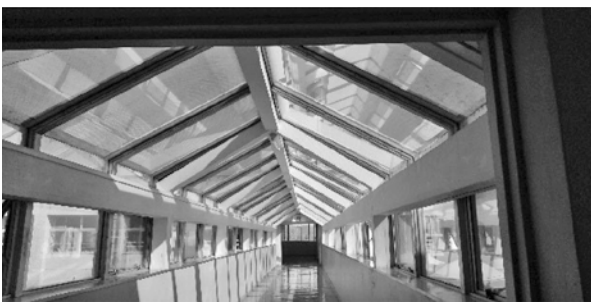
老朽化が心配される玉ノ岡中学校渡り廊下
