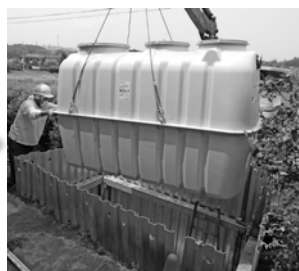
② 合併浄化槽設置
