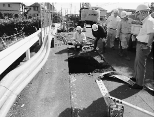
下水道管道路陥没
