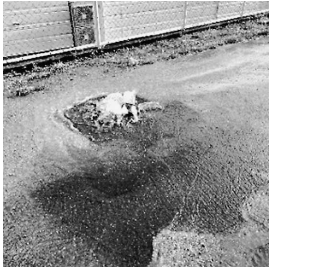
水道管の老朽化
